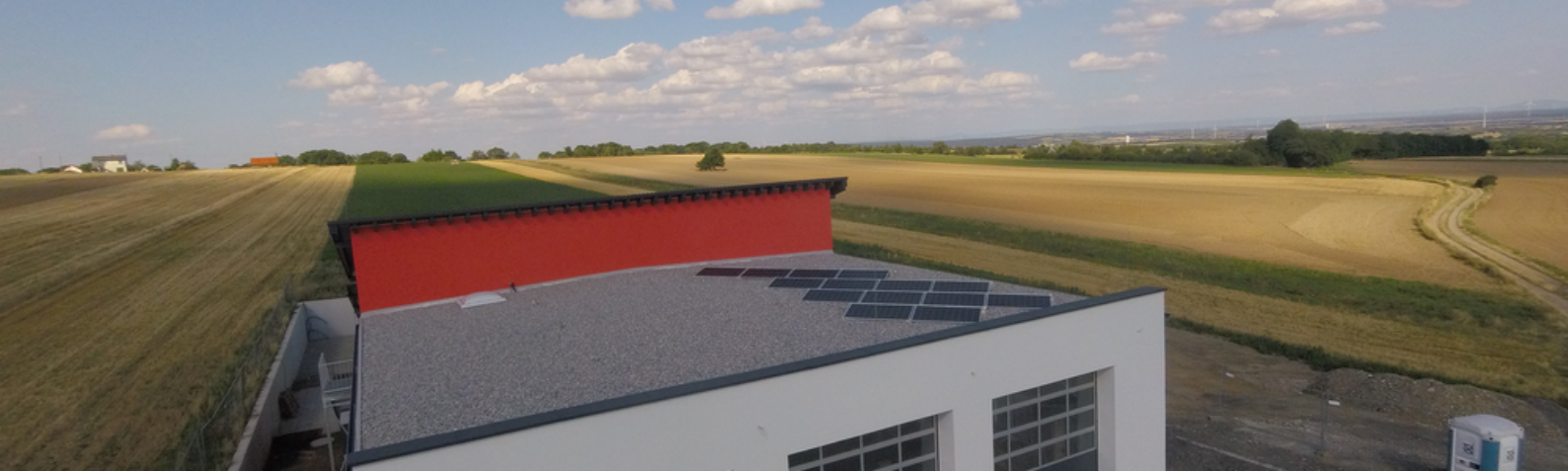
Die PV-Anlage der FF Manhartsbrunn.
