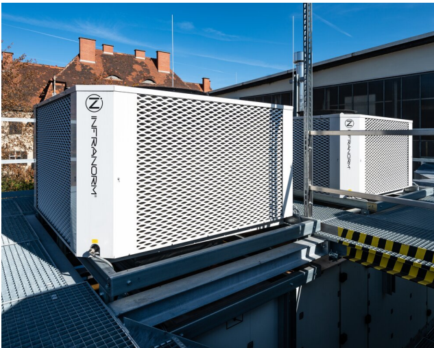
Mischluftgerät mit aufgesetzter zweistufiger adiabater Kühlung
