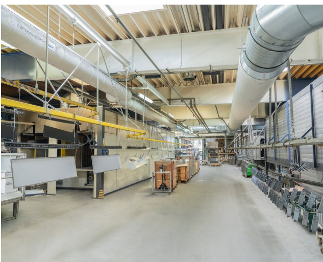
Zufuhr der gekühlten Frischluft
